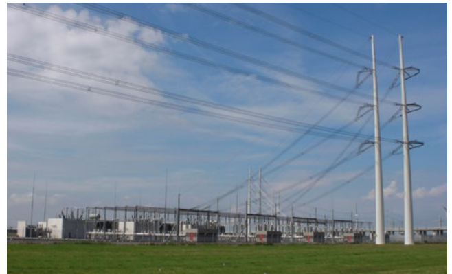
Niederlande: Das Wintrack-System von TenneT reduziert die elektromagnetische Strahlenbelastung um 60%.
