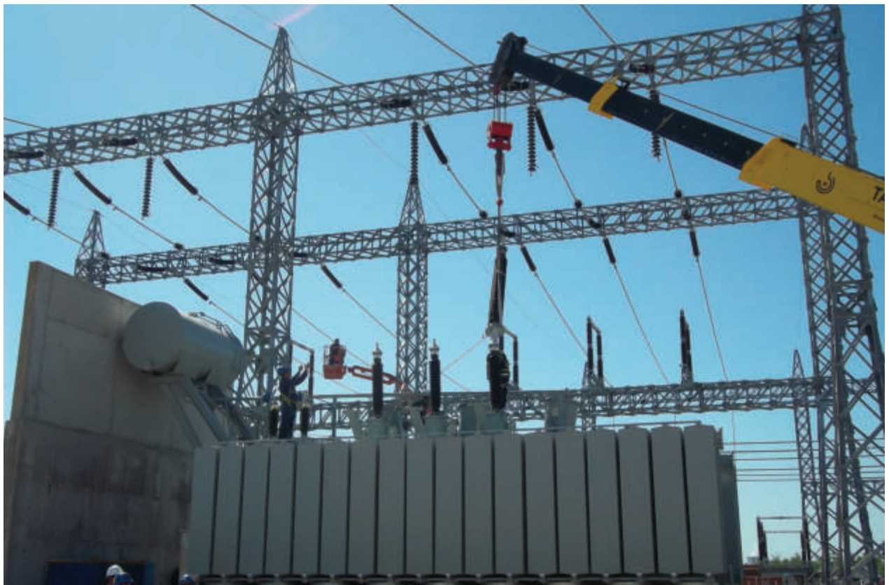
Ministerio de Obras Publicas S.E. Ensenada de Barragan, Armado, Montaje y Conexionado Transformador 220 kV Assembly and Connection 220 kV transformer
