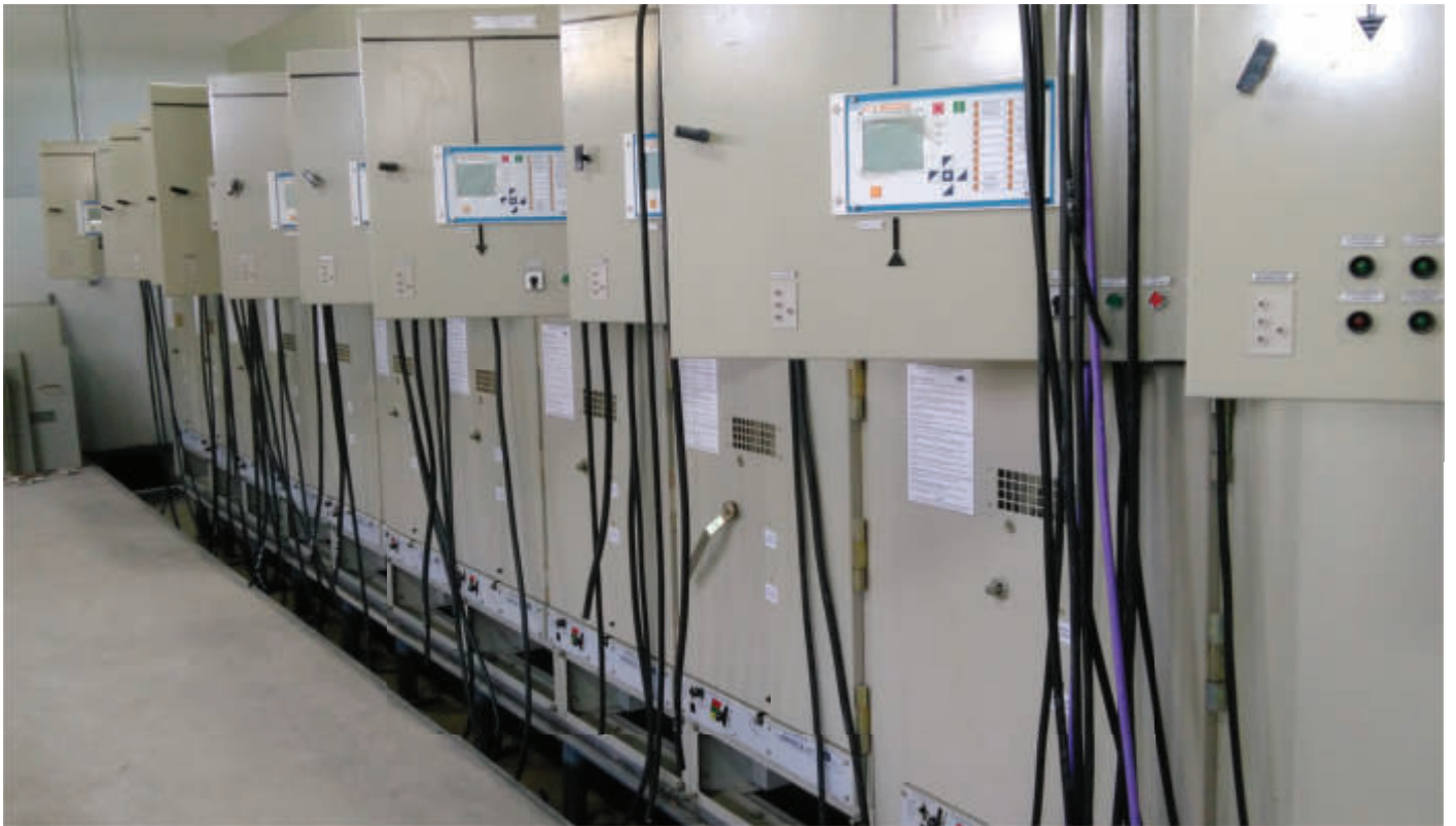
Edenor Subestación Aniversario, Celdas de Media Tensión, Montaje electromecánico Edenor Substation Aniversario, Medium Voltage panels, Electromechanical Assembly
