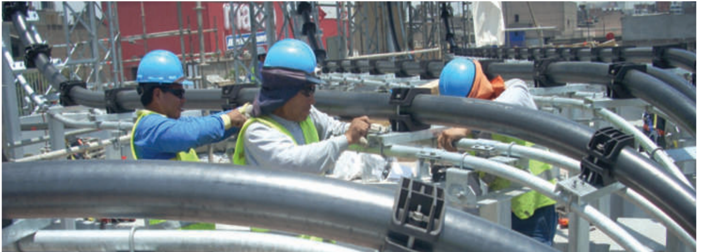
Luz del Sur Perú. S. E. Industriales Conexionado Soportes y Estructuras Metálicas para cables de 220 kV S. E. Industrial Connections Brackets and Metallic Structures for 220 kV cables
