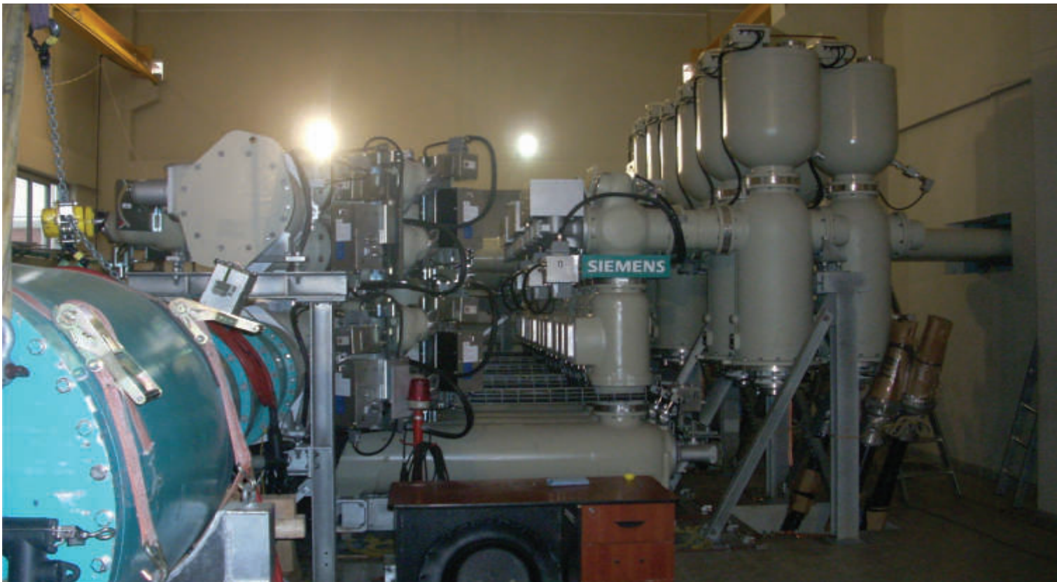
Luz del Sur Perú. S. E. Industriales Conexión GIS Siemens 220 kV - Siemens GIS connection
