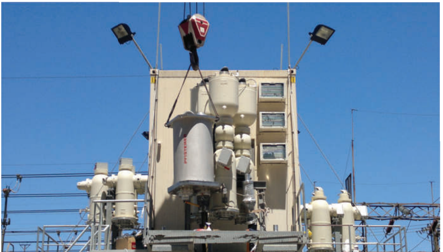
Central Costanera. Conexionado GIS SIEMENS 220 KV GIS SIEMENS 220 KV connection
