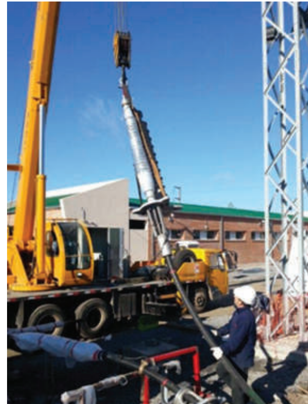
Edenor S.A. S.E. Aeroclub Conexionado de cable subterráneo en 132 kV 132 kV underground cable Connection
