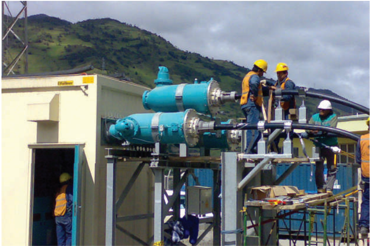
Hidropaute Represa Ecuador, Conexionado GIS Siemens - Siemens GIS connection
