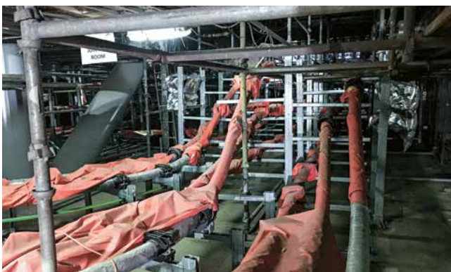
HV-Kabelanlagen im Inneren der Plattform. Die Kabel sind abgedeckt, um sie vor Hitze und Staub zu schützen.
