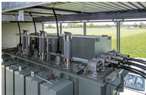
Kompakte Trafozelle , für die nur beschränkter Nutzraum zur Verfügung steht.
