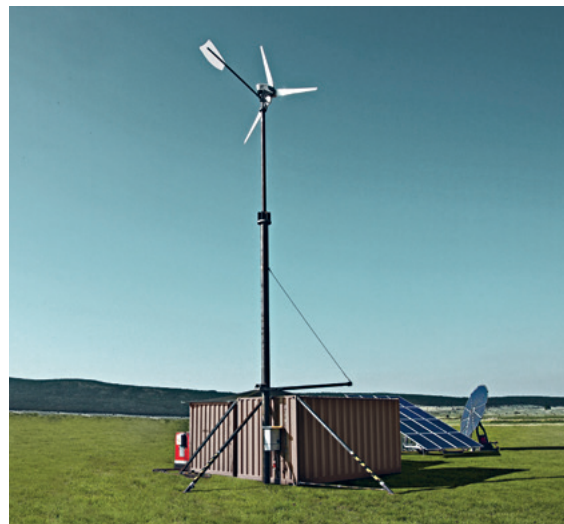
In der Praxis bewährt: Das CrossPower-System in Ungarn
