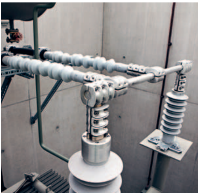
PFISTERER-Sonderlösung für den Anschluss der neuen Transformatoren im Umspannwerk Verbois: Verbindung von Transformator-Durchführung auf Energieableitung mit integrierter Überspannungsschutztechnik.
