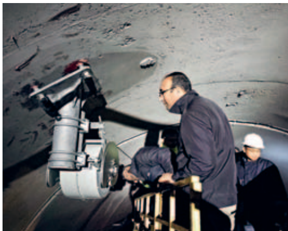
Verantwortliche der Eisenbahngesellschaft TCDD und des Eisenbahn-Bauunternehmens CRCC begutachten die Installation eines TENSOREX C+.
