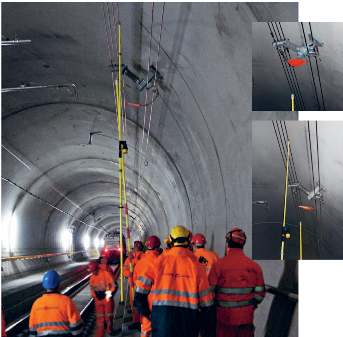
Feldtest im Tunnel mit Bravour bestanden.
