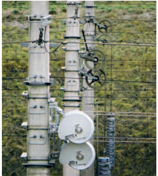
Testinstallation von TENSOREX C+ im ÖBB-Netz: Die patentierte PFISTERER-Lösung (vorne links) ist deutlich schlanker und unauffälliger als herkömmliche Radspanner (hinten rechts).
