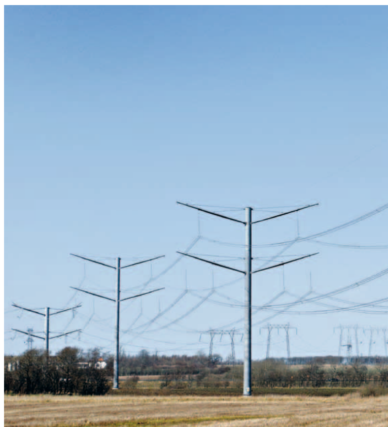
Für hochmoderne Freileitungen in ästhetischem Design liefert PFISTERER anwendungsspezifisch ausgelegte Komplett-Lösungen aus einer Hand.
