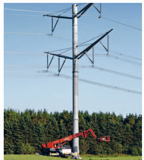
Umfangreich getestete Isolatorenketten gewährleisten reibungslose Montage und dauerhaft zuverlässigen Betrieb.
