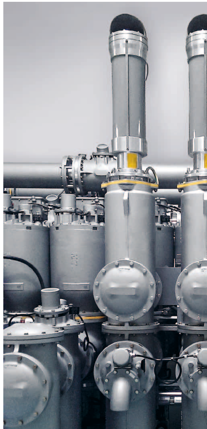
Kostenoptimierte Retrofit-Lösung für UW Niedergösgen: Standard-Endverschluss-Gehäuse des GIS-Anlagen-Herstellers kombiniert mit HV-CONNEX-Geräteanschlusssteil und HV-CONNEX-Ableiter Größe 4 von PFISTERER für Erweiterung der einphasigen Schaltanlage
