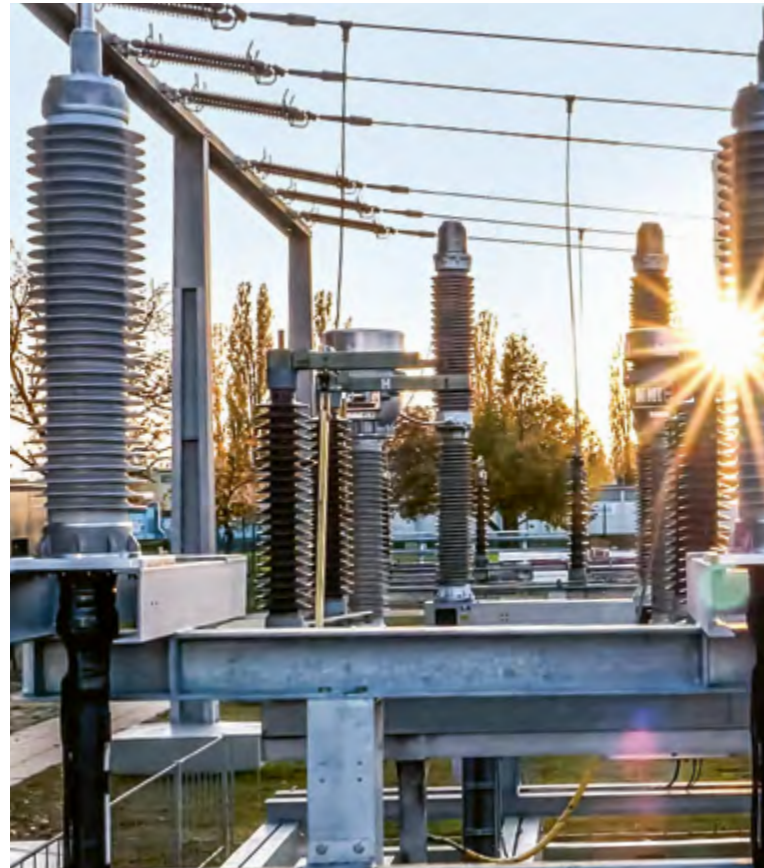
Im Umspannwerk in Graz erfordert der wartungsfreie Betrieb der umweltsicheren Endverschlüsse künftig weniger Überwachung.
