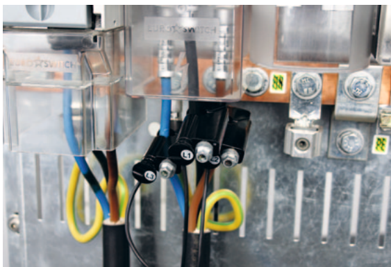
PLCON für den Anschluss von Datenkonzentratoren
