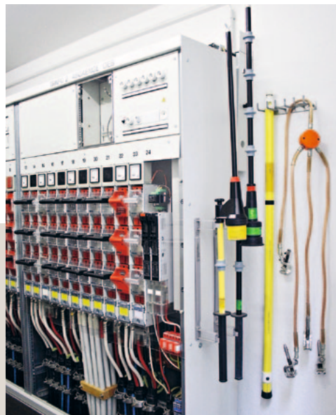
Spannungsprüfer und Erdungsgarnitur von PFISTERER griffbereit neben Verteilung mit PFISTERER-Schaltleisten
