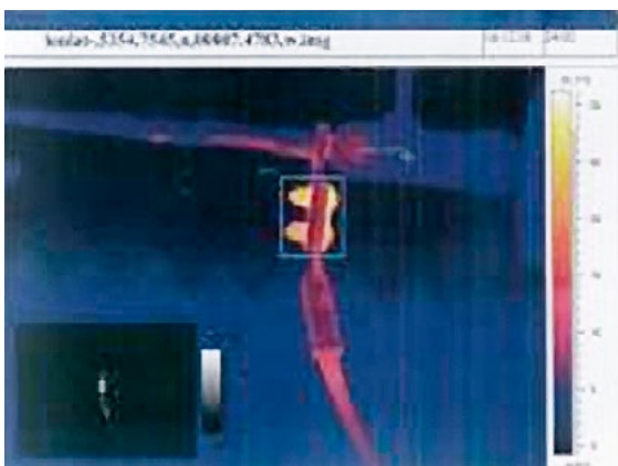
Bild 1: Die Auswertung des Wärmebildes ergibt: die Schrauben sind die mit Abstand heißeste Stelle in der geprüften Klemmenanordnung. Das heißt: der Strom fließt über die Schrauben statt über die Kontaktstellen – ein Vorbote des Kontaktausfalls
