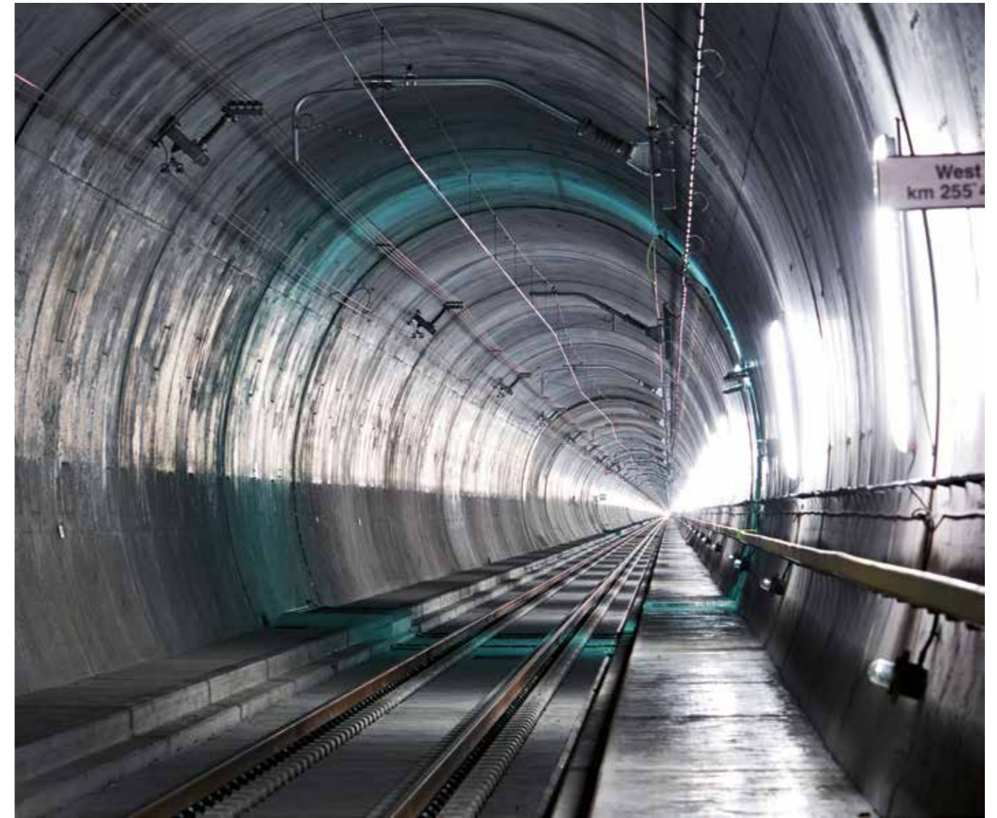
Für zuverlässigen Einsatz unter harten Bedingungen: PFISTERER lieferte bewährte und speziell angefertigte Erdungs- und Kurzschließgarnituren für den neuen Gotthard-Basistunnel, der mit 57 km Gesamtlänge als der derzeit längste Eisenbahntunnel der Welt gilt. (© AlpTransit Gotthard AG)
