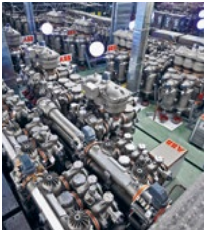
Wegweisende Innovation: Die Hochspannungsschaltanlage von ABB verbindet die platzsparende Bauweise von gasisolierten Schaltanlagen mit einzigartig niedrigen CO 2 -Äquivalent-Werten – dank neuartiger Schaltanlagentechnologie mit patentiertem GIS-Gasgemisch.
