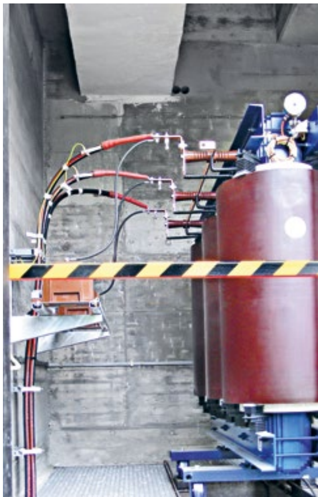
Bild 5: Ein sehr hohes Störfeldrisiko bergen Spannungsprüfungen an Gießharztransformatoren – erst recht, wenn die zu prüfenden Stromschienen, wie hier, nur von der Seite kontaktiert werden können.
