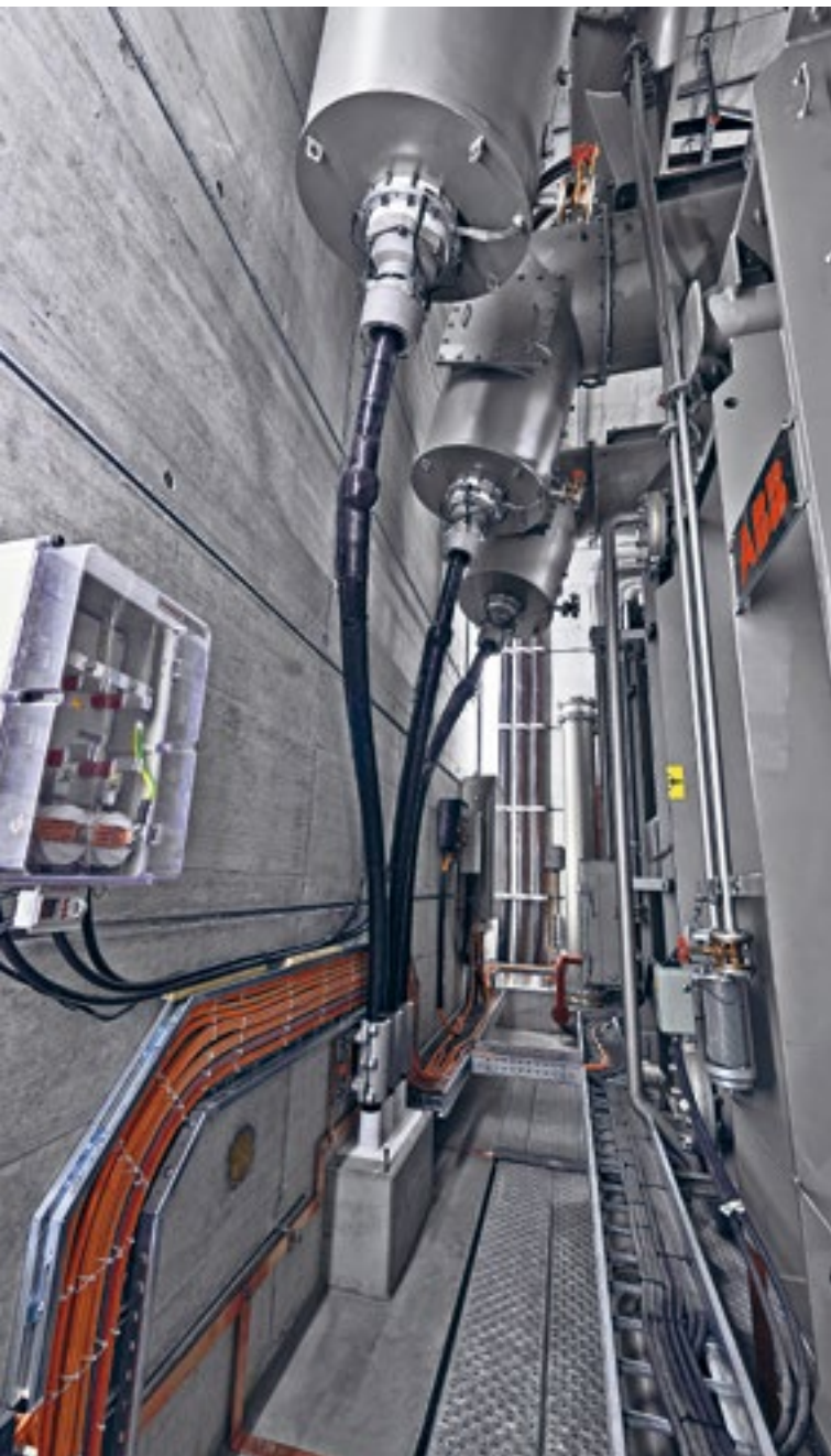
Berührungssicher unter Hochspannung: Drei Kabelanschlüsse am 50-MVA-Transformator ausgeführt mit gekapseltem HV-CONNEX-System der Größe 6 für 170 kV sowie Erdtrennerkasten für die effiziente Schirmbehandlung
