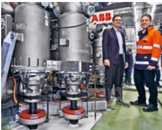
Partner für Versorgungssicherheit: Pascal Müller, Gesamtleiter des neuen Umspannwerks Oerlikon (links) und Reto Aeschbach, Verkaufsleiter bei der PFISTERER SEFAG AG (rechts) freuen sich über die gelungene Fusion umweltfreundlicher Technologien: trocken isolierte HV-CONNEX-Kabelanschlüsse von PFISTERER im Einsatz an ökogasisolierter HV-Schaltanlage von ABB (links im Bild).
