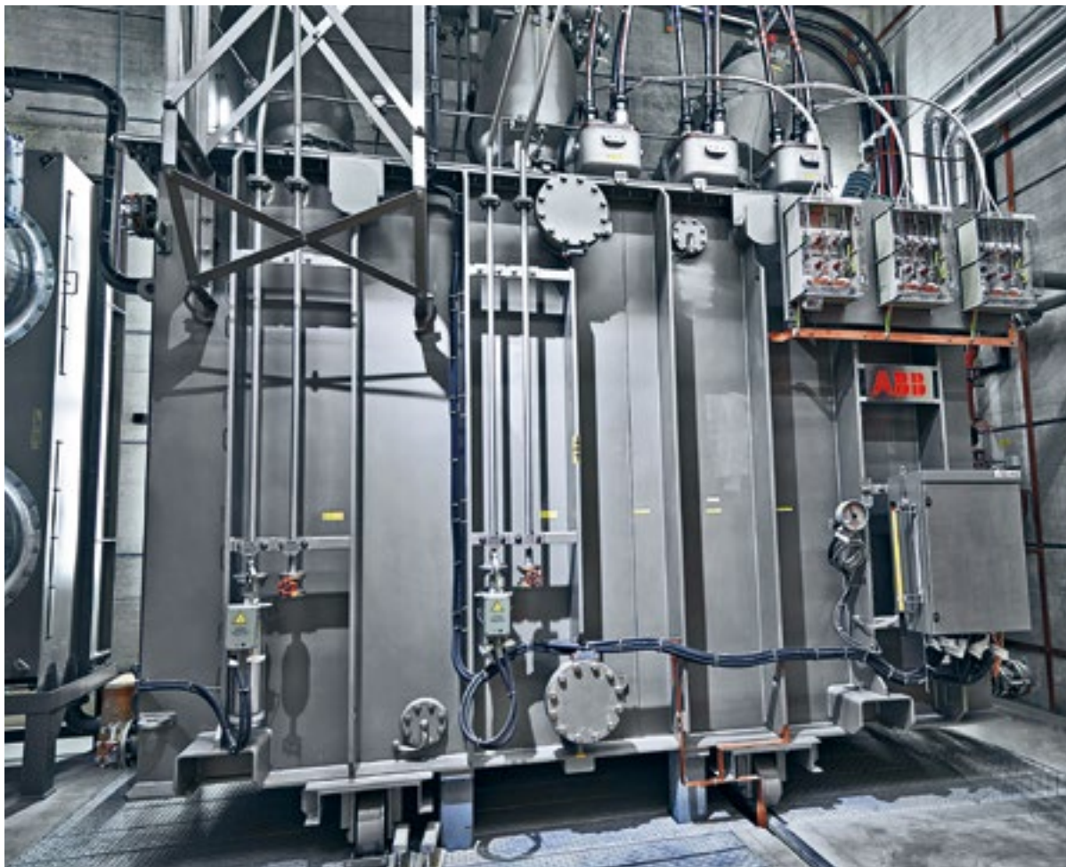
Effiziente Raumnutzung: 50-MVA-Leistungstransformator von ABB installiert in einer der unterirdischen Transformatorzellen des neuen Umspannwerks Oerlikon, angebunden an Wärmekoppler für energiesparende Wärmenutzung und ausgestattet mit kompakten Anschluss- und Überwachungslösungen von PFISTERER
